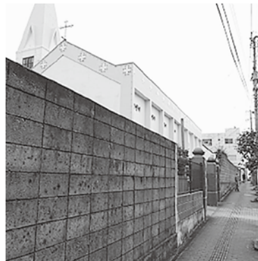
教会外構のブロック塀は敷設後五十年以上経過しており、地震等で崩落の危険もある
